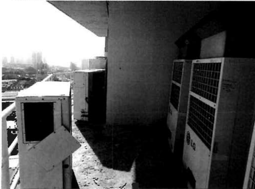
VISTA GENERAL DEL ÁREA DE MAQUINAS DE A/A
