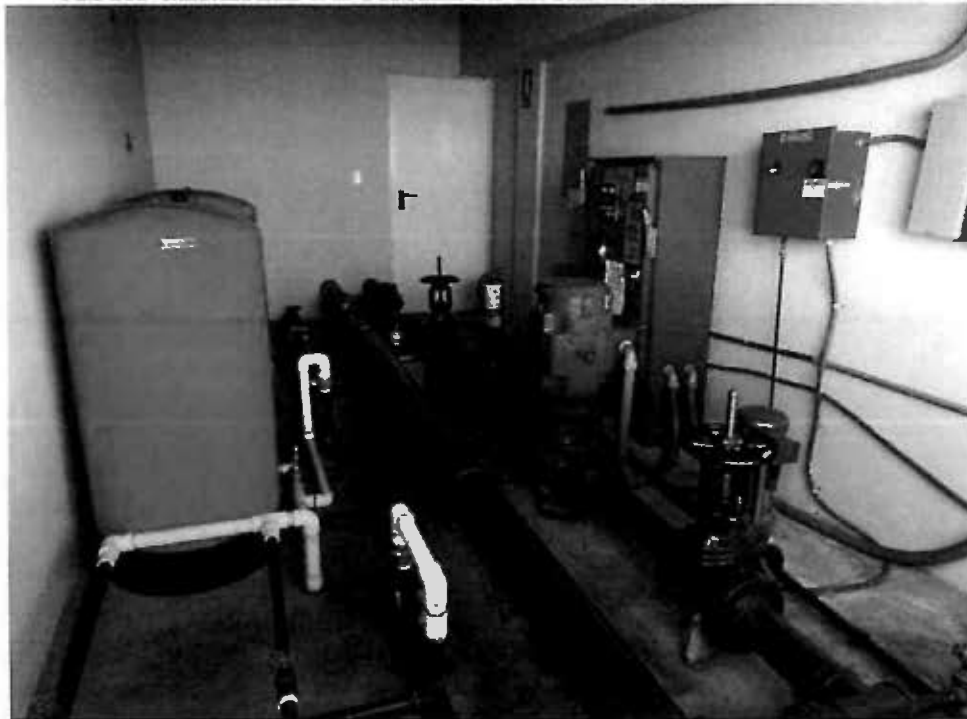
VISTA GENERAL DEL CUARTO DE BOMBA EN EL NIVEL 1800
